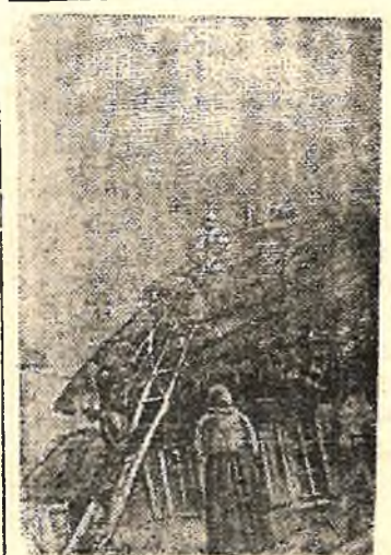
На снимке: Войцы Н-ской части Ф. Е. Букви и Ф. Я. Якубовский в прифронтовом селе Сталинградской области ремонтируют крышу хаты семьи красноармейца О. И. Степанова.
