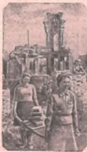
На снимке: рабочие 5-го строительного участка Северо-Кавказской железной дороги на восстановительных работах. Впереди стахановки — комсомолки Э. С. Кавва (слева) и Р. А. Ивченко.
